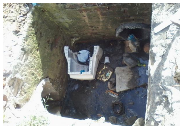
Figura 2: Presença de lixo eletrônico nas galerias
