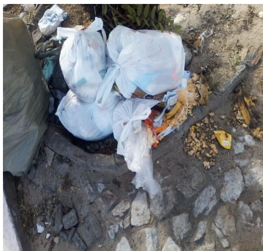
Figura 3: Galeria obstruídas por lixo orgânico
