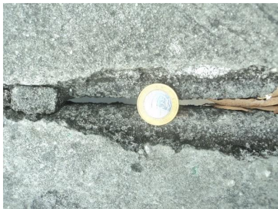
Figura 11. Ausência de parte da junta de dilatação na passarela 5.
