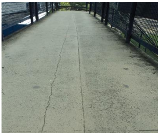
Figura 12. Junta de dilatação fora do eixo na passarela 2
