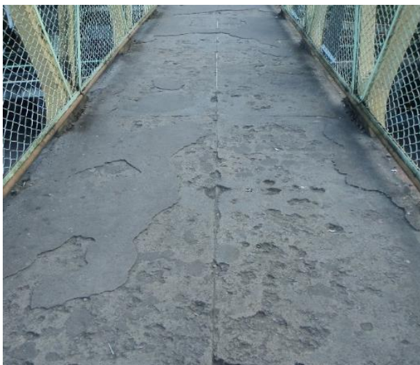
Figura 15. Desgaste do concreto no piso da passarela 4.
