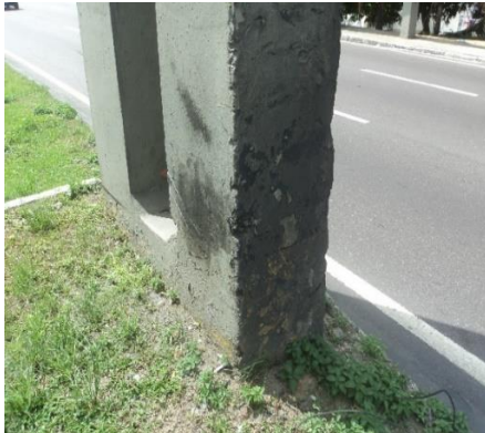
Figura 14. Pilar central da passarela 2 com desgaste devido a impactos.
