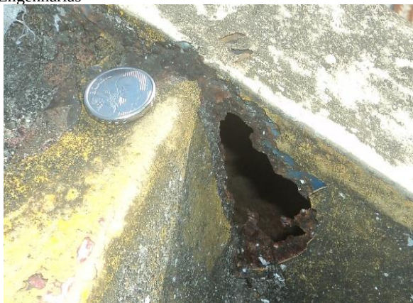
Figura 9. Processo de corrosão em componente metálico da passarela 6.
