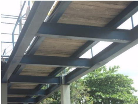
Figura 13. Passarela 1 com viga do tabuleiro deformada pela ação de veículos altos.
